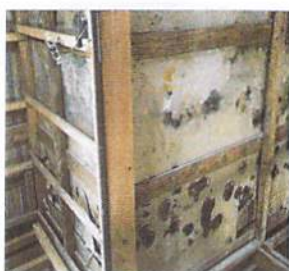
壁の裏に大量のカビを確認
